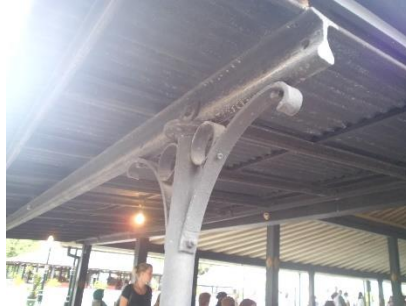
Figur 29. Kerusakan pada Kolom Besi Tuang Bangsal Sri Manganti (Sumber: Dokumen Pribadi, November 2016)
