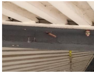
Figur 26. Kerusakan pada Balok Utama Bangunan (Sumber: Dokumen Pribadi, November 2016)
