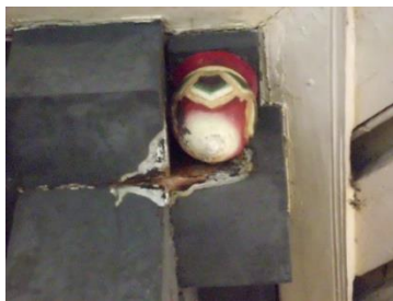
Figur 27. Bagian Balok yang Ditumbuhi Jamur (Sumber: Dokumen Pribadi, November 2016)
