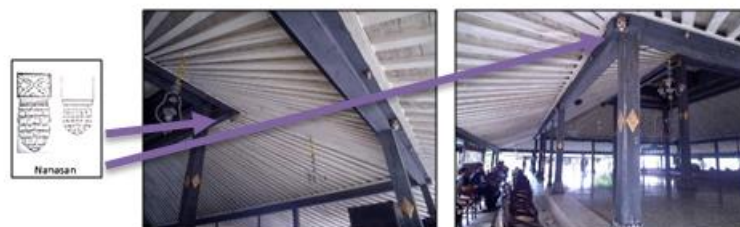
Figur 15. Balok dan Ornamen Nanasan pada Bangsal Sri Manganti (Sumber: Dokumen Pribadi, November 2016)
