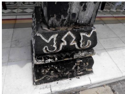
Figur 30. Keropos dan Retak pada Umpak (Sumber: Dokumen Pribadi, November 2016)
