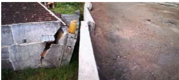
Gambar 5 Kondisi Keruntuhan Abutmen Jembatan Akibat pada Tanah Lunak Berdampak pada Bangunan Sekitar
