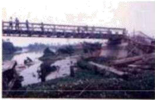
Gambar 1 Kondisi Penurunan Timbunan Oprit Jembatan di Lokasi Pantura yang Selalu Di-overlay
