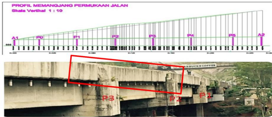
Gambar 9 Kelengkungan pada Profil Memanjang Jembatan Cisomang
