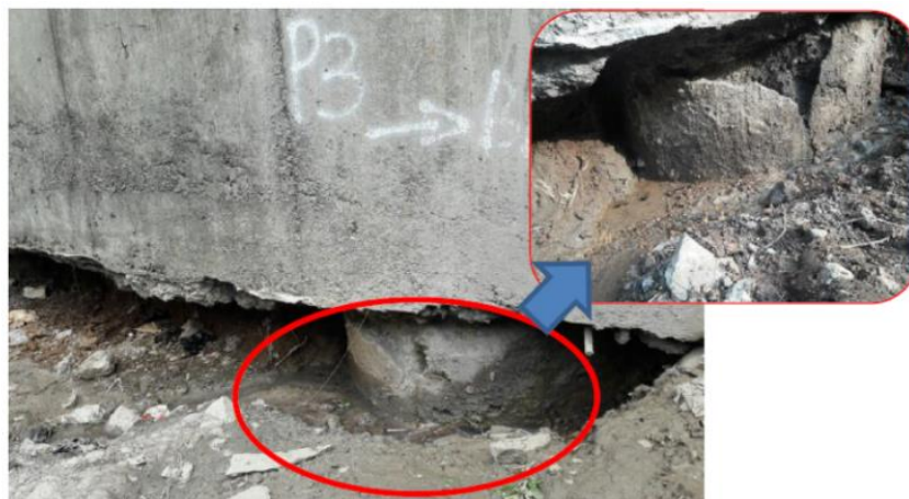
Gambar 3 Keropos pada Pondasi Bore Pile Pilar P3
