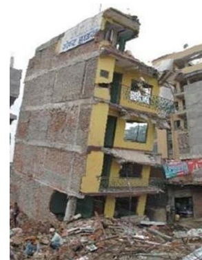
Gambar 1. Keruntuhan Gedung Dengan Kondisi soft story akibat gempa Nepal [2]
