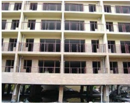
Gambar 2. Kondisi soft story pada lantai dasar di Dujiangyan [3]
