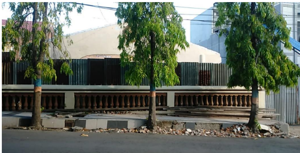
Gambar 3 Kondisi Ruas Jalan Melati Depan Pembangunan Melati Medical Clinic
