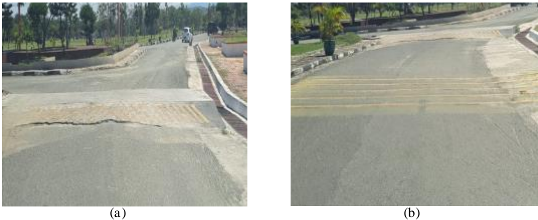
Gambar 3 Kondisi Marka Jalan
