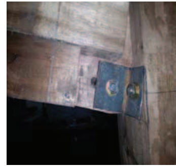
Gambar 12. Kegagalan tumpu pada kayu sekitar batang baja tumpu benda uji M9B1.
