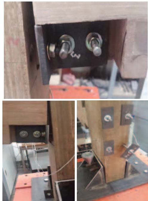
Gambar 13. Kegagalan batang baja tarik akibat pembebanan di benda uji M9B2.
