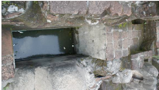
gambar 4. 6 pintu air 1 (sumber: dokumentasi pribadi)
