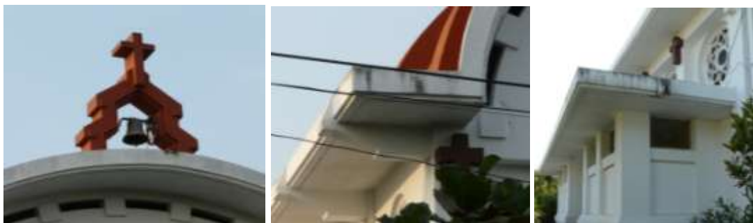
Gambar 6.2 Kondisi Atap Gereja Bintaran
