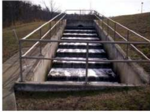
Gambar10.5.13 : Aerasi dengan sistem cascade aerators
