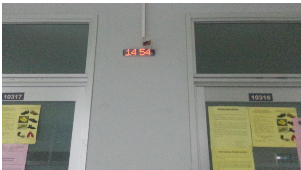
Gambar 8. Jam Digital yang dipasang di Lantai 3 Gedung 10
