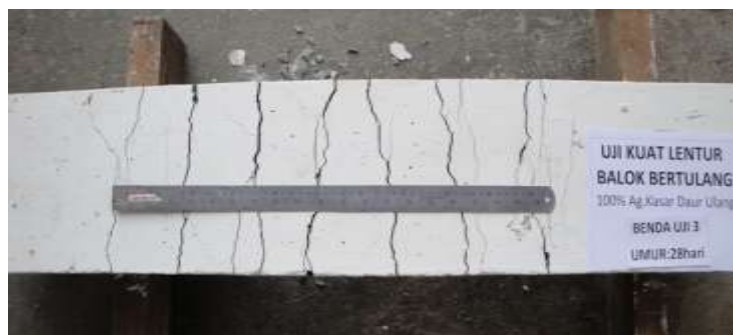
Gambar 4.7 Pola Retak Akibat Uji Lentur Pada Balok Beton Bertulang 100%RCA
