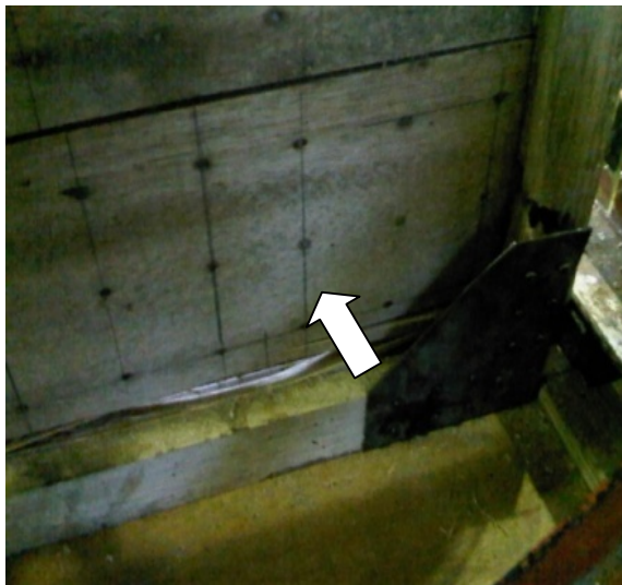
Gambar 4.24 Kegagalan tarik pada batang vertikal dekat hold-down plate
