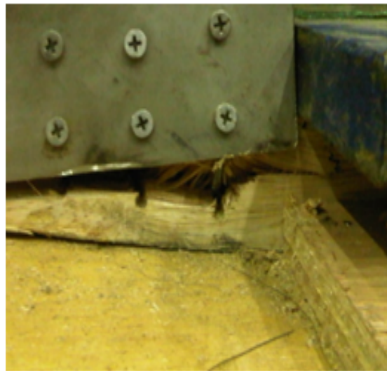
Gambar 4.25 Kerusakan pada hold down steel plate
