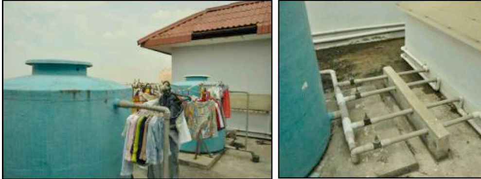
Gambar 4.35. Tangki Air Atas Rusun Cinta Kasih
