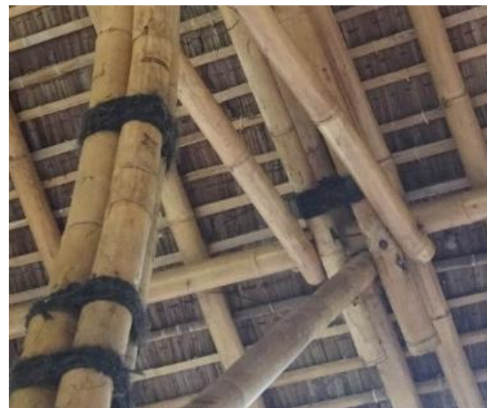
Gambar 16. Penggunaan batang balok yang mengikat antar struktur
