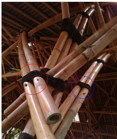
Gambar 15. Penggunaan bracing pada struktur bangunan
