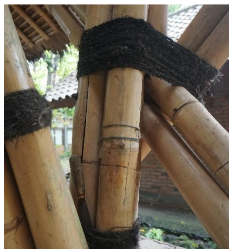
Gambar 16. Penggunaan batang balok yang mengikat antar struktur
