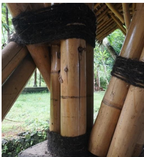
Gambar 15. Penggunaan bracing pada struktur bangunan
