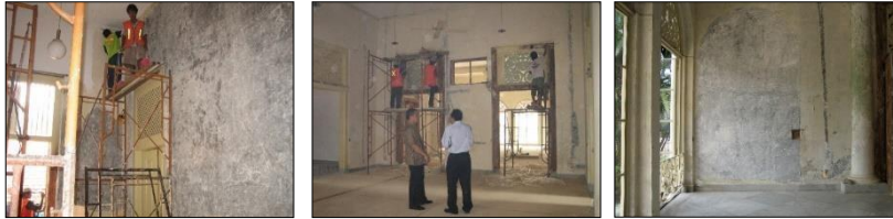
Figur8. Keadaan Konservasi Dinding
