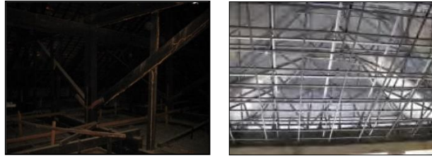
Figur12. Keadaan Eksisting Atap dengan Struktur dan Struktur Baja Ringan (Sumber: Laporan Tim Perancang)
