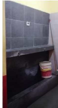
Gambar 25. Kondisi Ruang Wudhu Wanita Pada Lantai 2 Masjid Al Imtizaj, Bandung (Sumber: Dokumentasi Pribadi)
