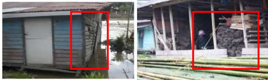
Gambar 13. Kerusakan Pada Elemen Kolom dan Dinding
