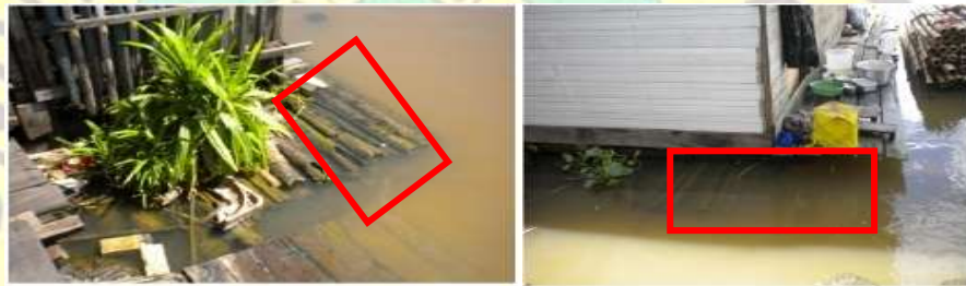
Gambar 12. Kerusakan Pada Bagian Pondasi
