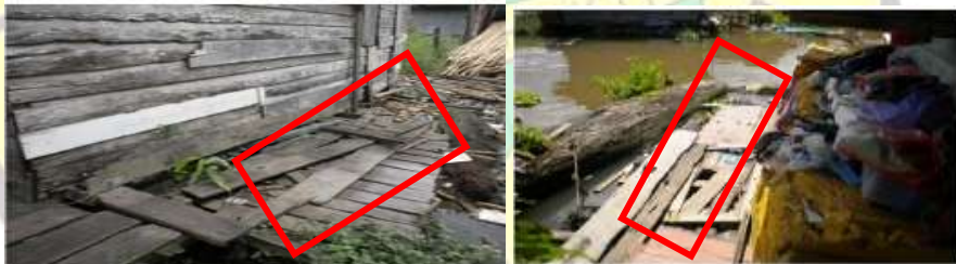
Gambar 13. Kerusakan Pada Elemen Lantai
